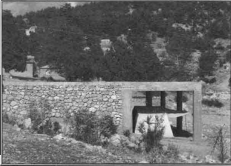
Fotoğraf 3.91. Avlan yaylasında yapılaşıma yasağı nedeniyle inşaatı durdurulan bir yayla konutu temeli ve hemen altındaki yaylacı çadırı.
